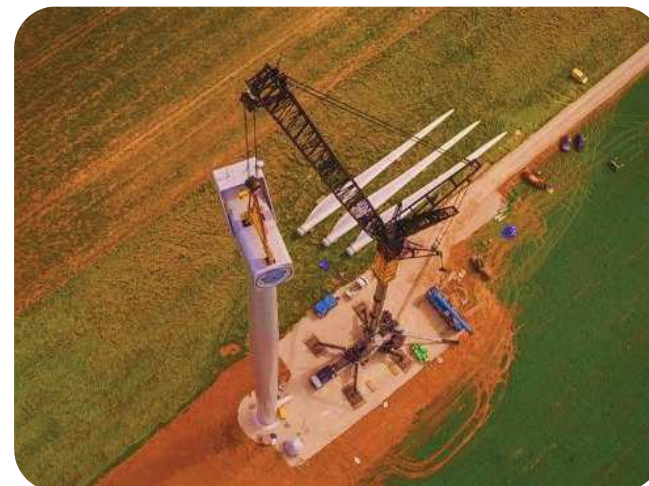
Figure 4 : Centrale Eolienne Raucourt (20 MW)
