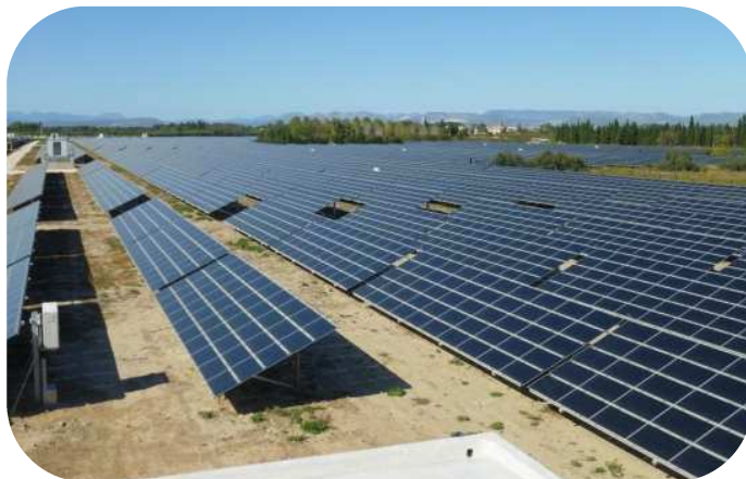
Figure 3 : Centrale solaire de Toreilles (12 MWc)
